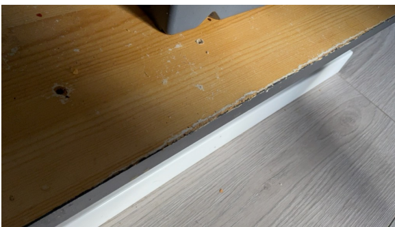
Eksempel på slitasje.
