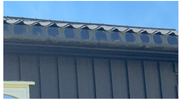
Eksempel på misfarging
