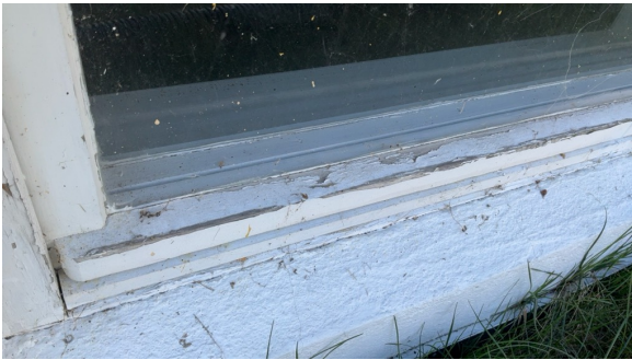
Eksempel på slitasje.
