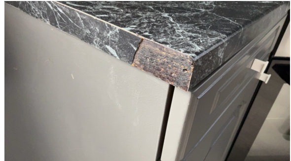
Eksempel på slitasje.
