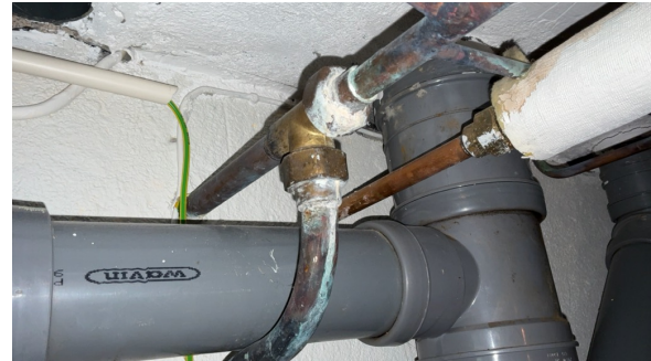
Stedvis korrosjon på skjøter
