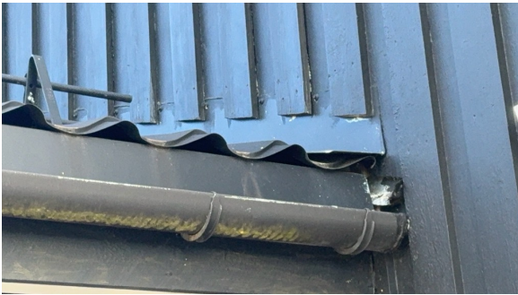
Beslag ligger delvis utenpå kledning.
