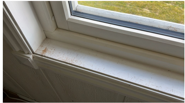
Eksempel på slitasje.
