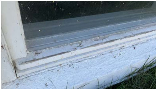
Eksempel på slitasje.
