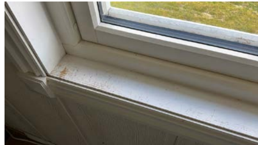
Eksempel på slitasje.
