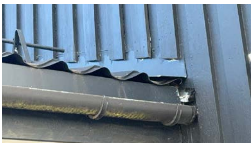
Beslag ligger delvis utenpå kledning.
