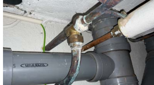
Stedvis korrosjon på skjøter
