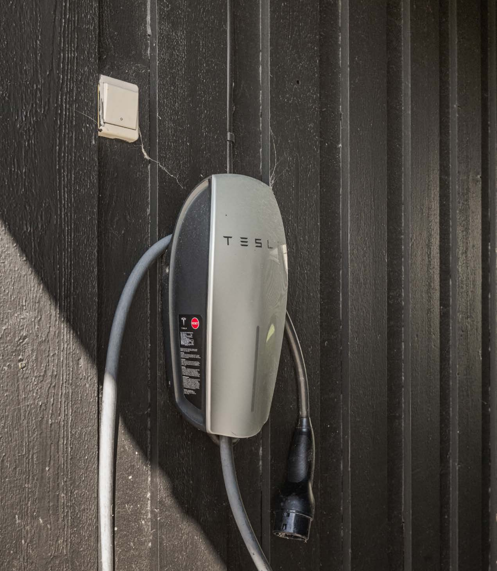
Elbillader installert i 2020.
