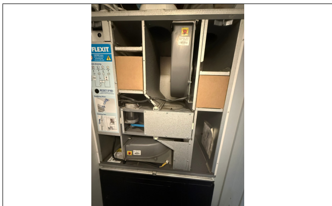
Bilde av ventilasjonsaggregat som er rengjort og har fått byttet filter.
