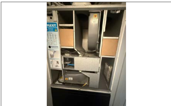
Bilde av ventilasjonsaggregat som er rengjort og har fått byttet filter.
