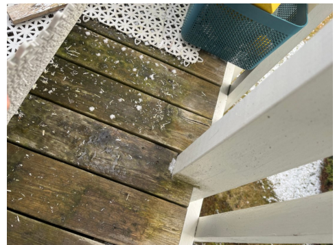
Gulv under plastfliser har manglende vedlikehold.
