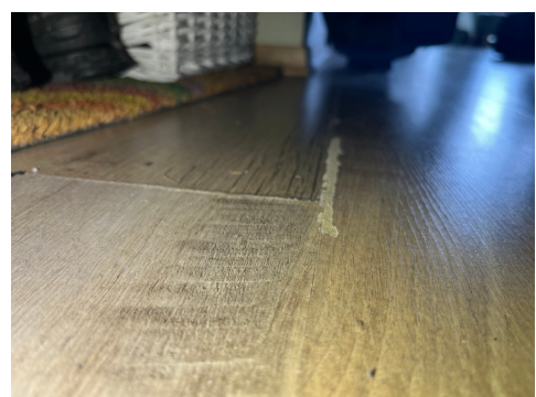
Laminatgulv i entre har skader i overflate.
