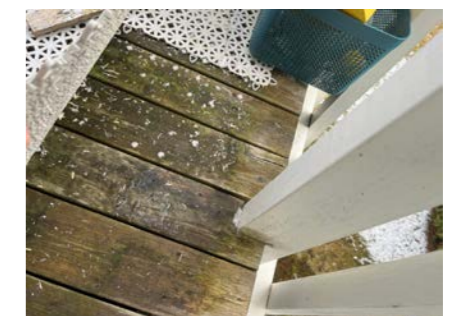
Gulv under plastfliser har manglende vedlikehold.
