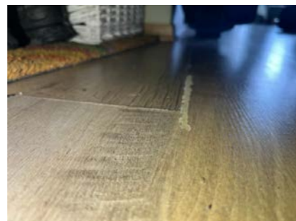
Laminatgulv i entre har skader i overflate.
