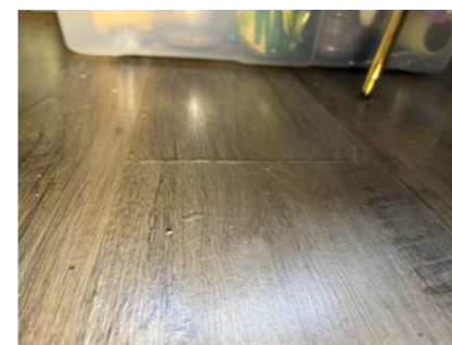
Laminatgulv i stue/kjøkken har svellet i skjøter.
