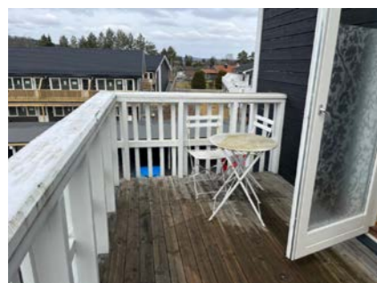
Veranda fra mesanin plan har slitasje og manglende vedlikehold.
