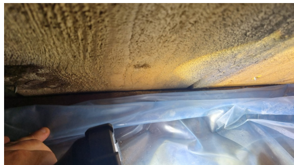
Ingen visuell luftespalte på isolert del av takkonstruksjonen.
