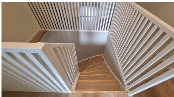
Det mangler håndløper på vegg i trappeløpet.
