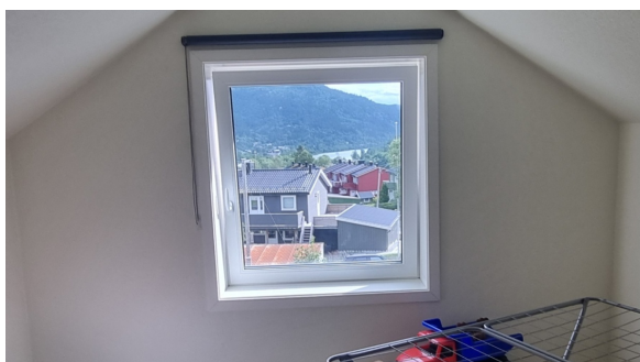
Vindu var vanskelig å lukke igjen etter det har blitt åpnet med sidehengsel funksjon.
