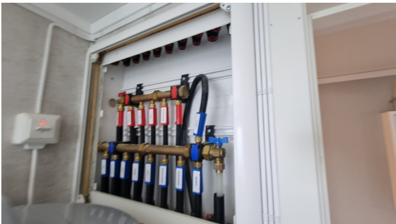
Innvendige vannledninger er av plast (rør i rør).
