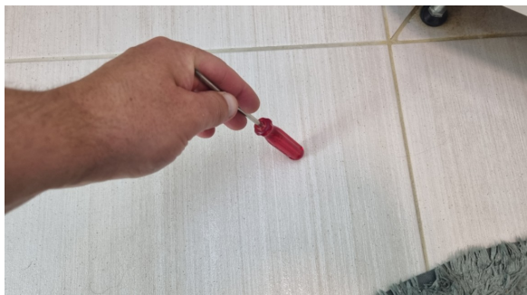
Det er påvist at noen fliser har bom (hulrom under).
