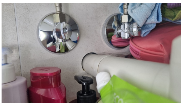
Det må tettes rundt rørgjennomføring i vegg.
