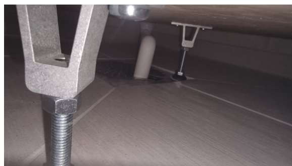
Sluket har begrensede inspeksjonsmuligheter på grunn av manglende rengjøring før befarings. Når sluket ikke er rengjort på forhånd, vil det ofte være umulig å kontrollere det grundig. Dette inkluderer å verifisere om mansjetten, membranen og klemringen er tilfredstillende utført.
