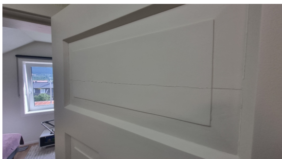
Sprekk i dørblad.
