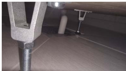
Sluket har begrensede inspeksjonsmuligheter på grunn av manglende rengjøring før befaring. Når sluket ikke er rengjort på forhånd, vil det ofte være umulig å kontrollere det grundig. Dette inkluderer å verifisere om mansjetten, membranen og klemringen er tilfredstillende utført.
