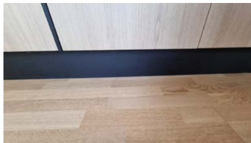
Det mangler luftespalte i sokkel under integrert kjøle- og fryseskap.
