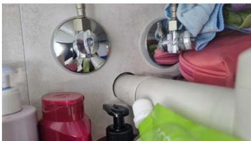
Det må tettes rundt rørgjennomføring i vegg.
