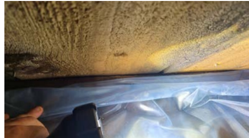
Ingen visuell luftespalte på isolert del av takkonstruksjonen.
