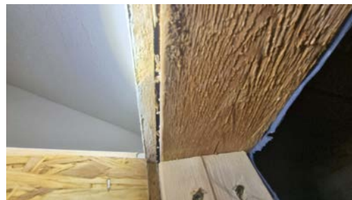
Ingen visuell synlig dampsperre på varm side av knevegg.
