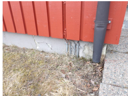
Avskallet puss på mur. Noe synlig isolasjon.
