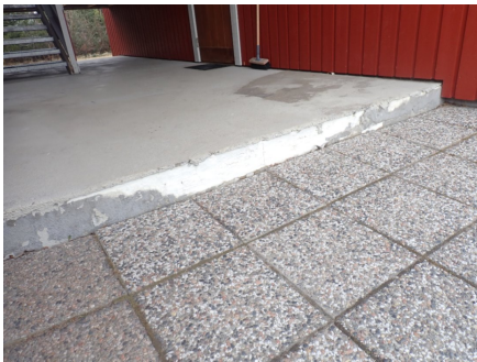
Avskallet puss på mur. Noe synlig isolasjon.
