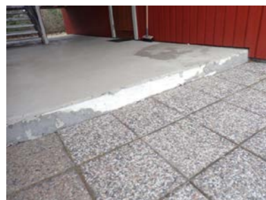
Avskallet puss på mur. Noe synlig isolasjon.
