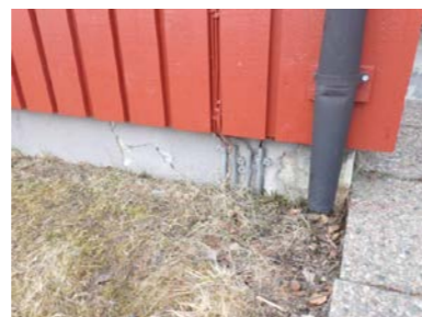
Avskallet puss på mur. Noe synlig isolasjon.
