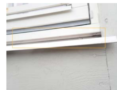
Vindusbeslag på baderomsvindu har sklidd ut av sporet i karmen.
