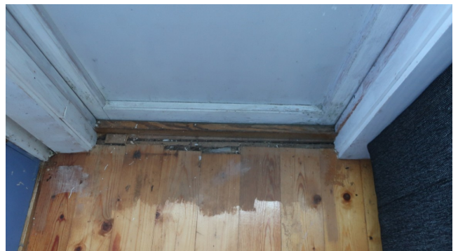
Mangler list ved terrassedør.
