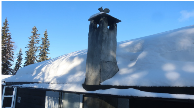
Pipen over tak.
