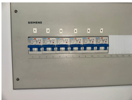
Sikringsskap med automatsikringer.
