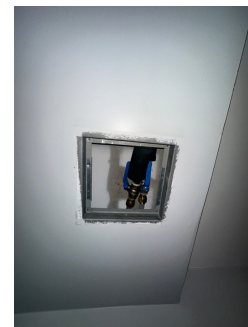
Stoppekraner plassert i luke i entre
