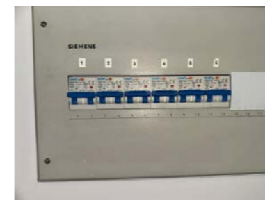
Sikringsskap med automatsikringer.
