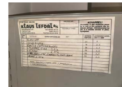
Kursoversikt i sikringsskap
