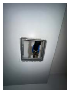
Stoppekraner plassert i luke i entre
