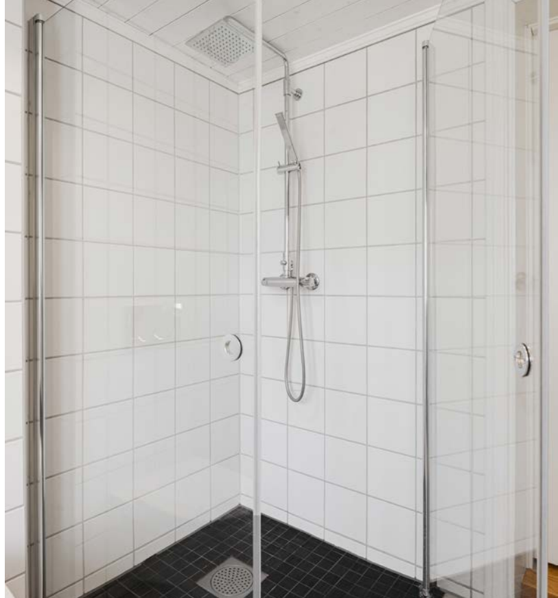
I tillegg er badet utstyrt med toalett og dusjhjørne med innfellbare dusjdører og veggmontert dusjbatteri.
