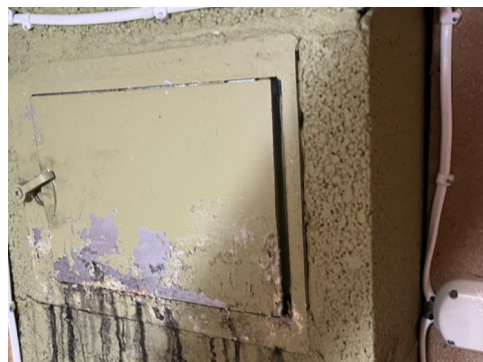
Avrenning av sotvann fra sotluken
