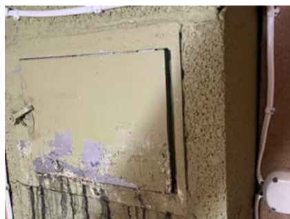
Avrenning av sotvann fra sotluken
