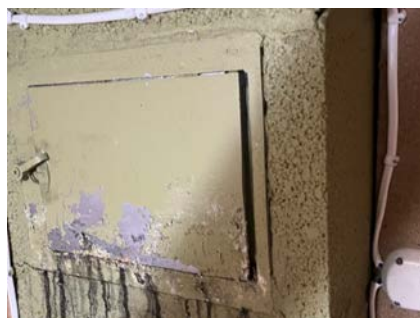
Avrenning av sotvann fra sotluken
