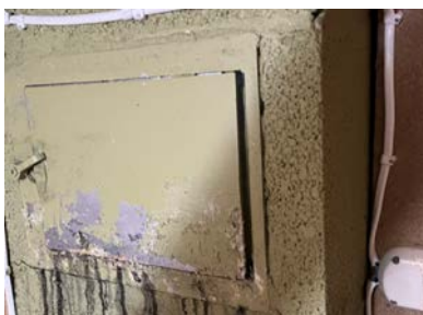
Avrenning av sotvann fra sotluken
