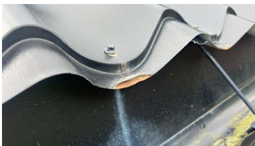
Rust og avskalling på taktekkingen
