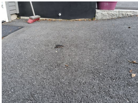
Stedvis noe fall mot boligen.
