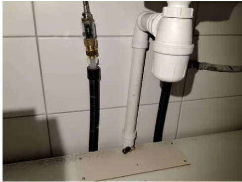
Boligen har synlige avløpsrør av plast.
