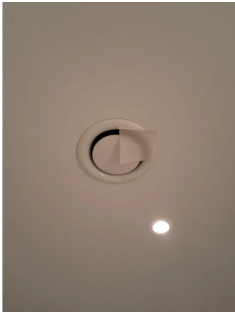
Avtrekkseffekten er testet med papir.
