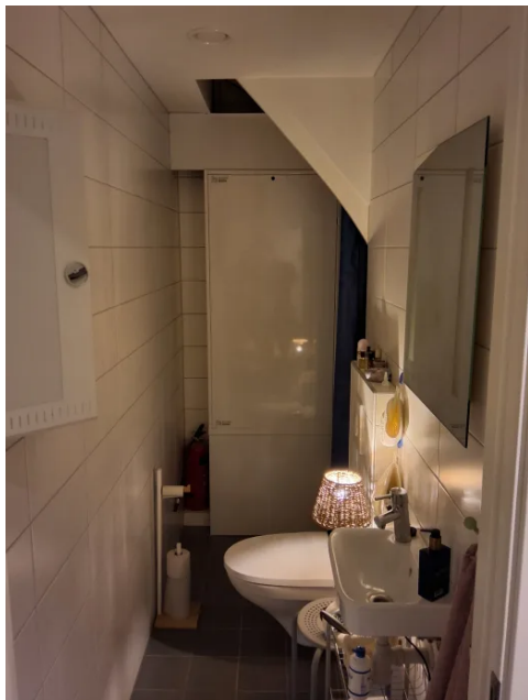
Oversiktsbilde toalett/teknisk rom.
