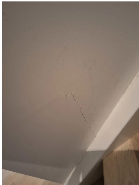
Riss på veggflate i trappegang.
