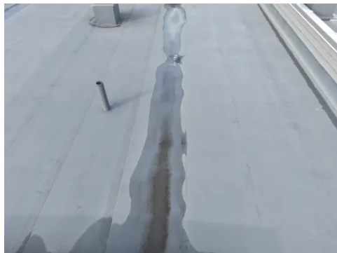
Det registreres vannsamlinger på taket.
