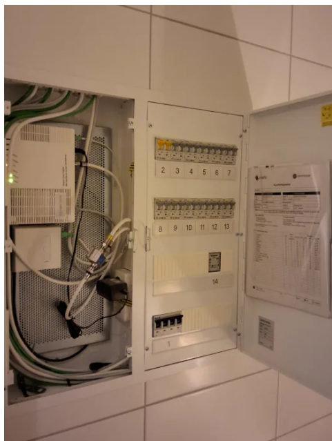
Sikringsskap er plassert på toalett/teknisk rom.
