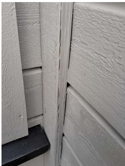
Det registreres avflasket maling på kledningen.
