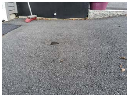
Stedvis noe fall mot boligen.
