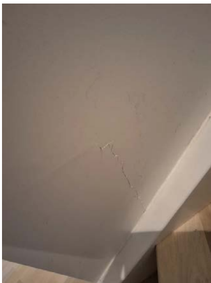
Riss på veggflate i trappegang.
