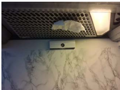
Avtrekkseffekten er testet med papir.
