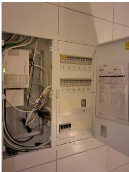
Sikringsskap er plassert på toalett/teknisk rom.
