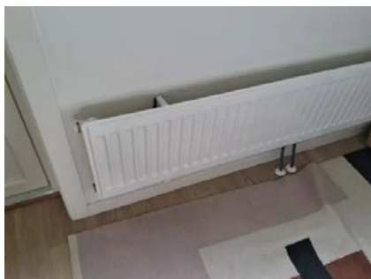
Soverom er oppvarmet med radiatorer.
