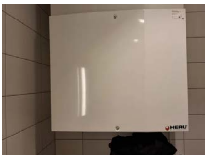
Ventilasjonsaggregat er plassert på bad.
