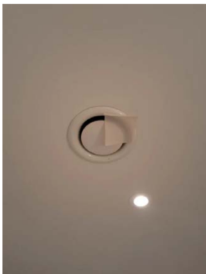
Avtrekkseffekten er testet med papir.
