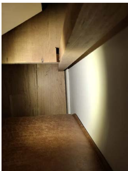
Glippe mellom parkett og gulvlist i stue.
