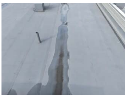
Det registreres vannsamlinger på taket.
