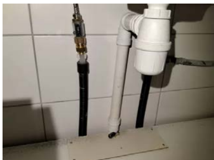
Boligen har synlige avløpsrør av plast.
