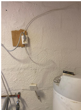
Løse ledninger og stikk på vaskerom.
