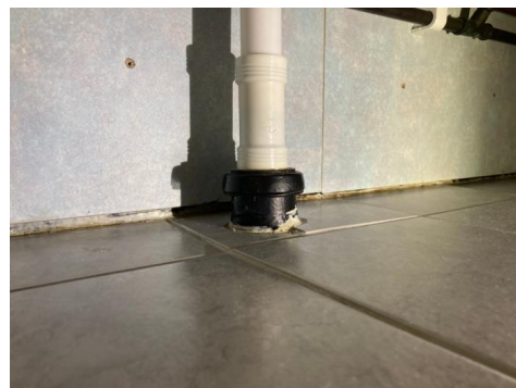
Det er ikke sokkelfliser på våtrommet.
