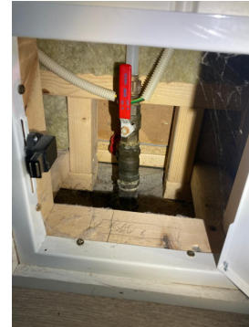
Stoppekran i vegg på soverom.
