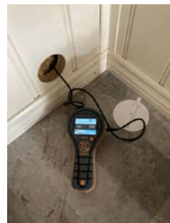
Fuktmåling i utforet vegg viste skadelig fukt.
