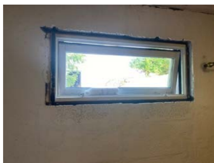
Vindu på vaskerom mangler utforing og lister.
