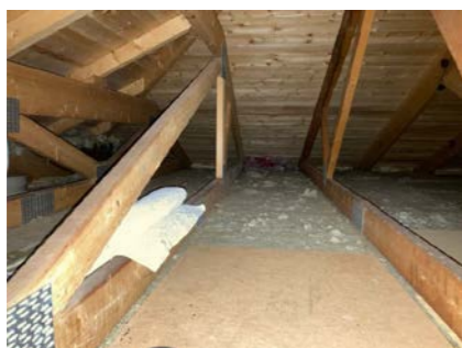
Ventilering ved takfot er tett med isolasjon på møneloft.
