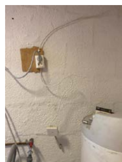
Løse ledninger og stikk på vaskerom.
