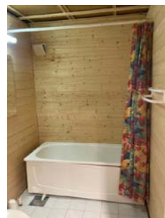
Det er ikke vanntilførsel til badekar.
