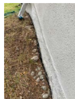
Synlig grunnmursplast uten topplst.
