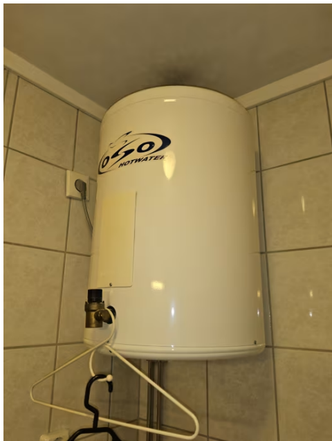
Vegghengt varmtvannsbereder plassert på bad.
