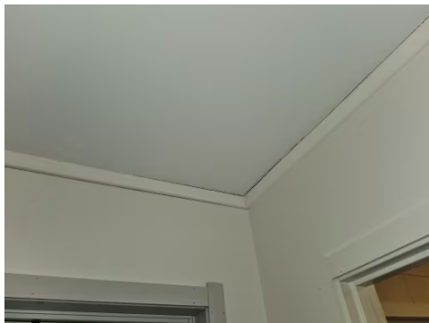
Riss/sprekker mellom listverk og overflater.
