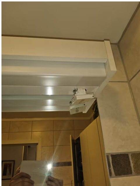
Løs/defekt stikkontakt i lysarmatur på vaskerom.
