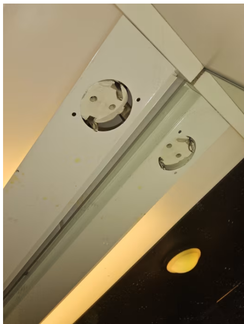
Løs/defekt stikkontakt i lysarmatur på bad.
