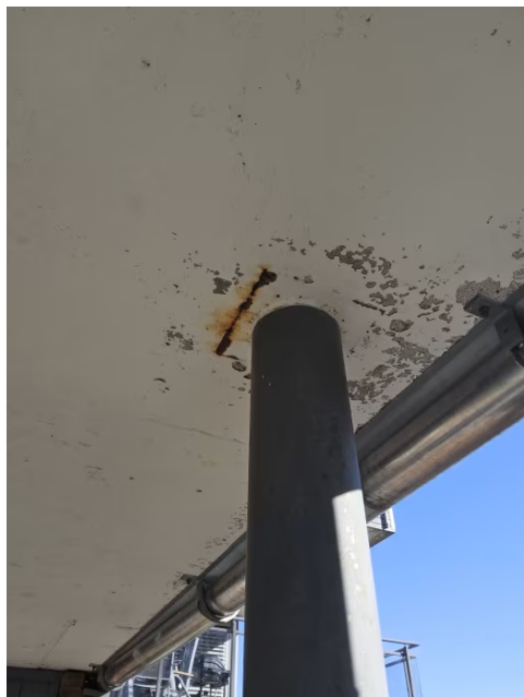
Avflasket maling og rustdannelser mot overliggende balkong.
