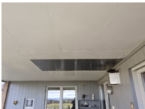
Kondensdannelser i betonghimling mot overliggende balkong ved eksosrør til gasspeis .
