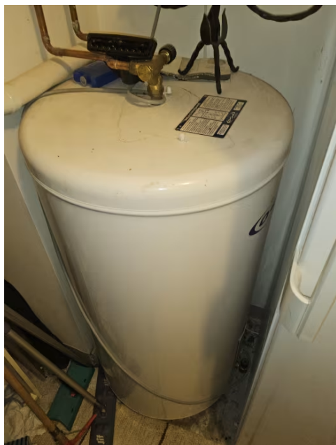
Varmtvannsbereder er plassert i bod.
