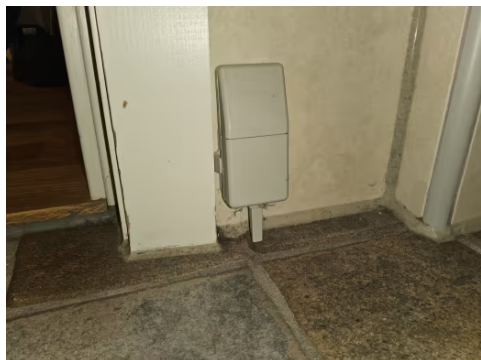
Trådløse fuktsensorer til automatisk vannstopper plassert ved dører på våtrom og ved varmtvannsbereder i bod.
