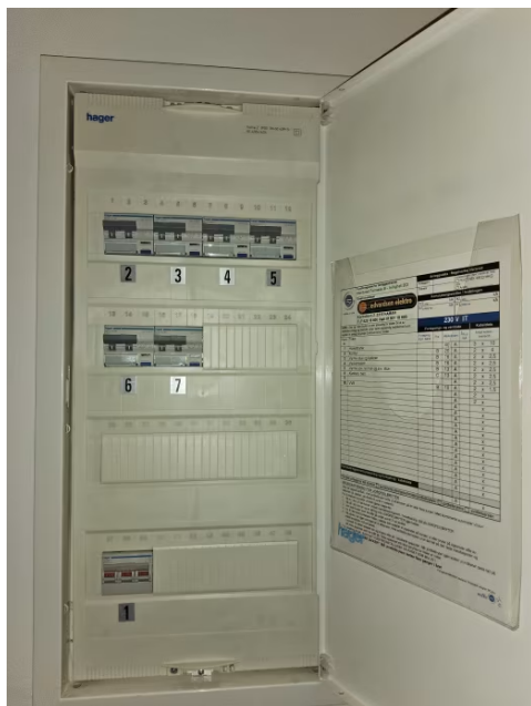
Sikringskap er plassert i gang.
