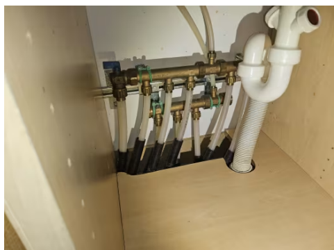
Åpen rørfordeling under kjøkkenvask.
