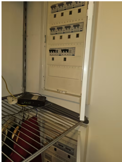
Sikringsskap er plassert på bod.
