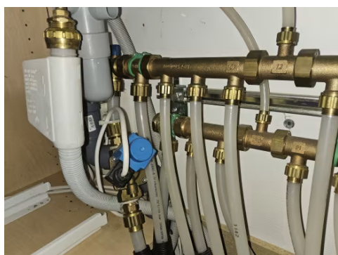
Åpen rørfordeling med automatisk vannstoppeventil under kjøkkenvask.
