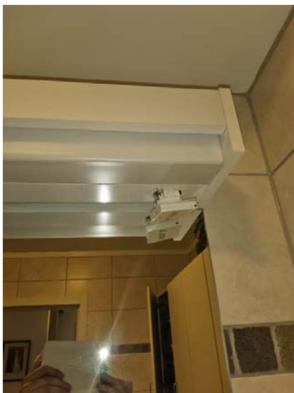
Løs/defekt stikkontakt i lysarmatur på vaskerom.
