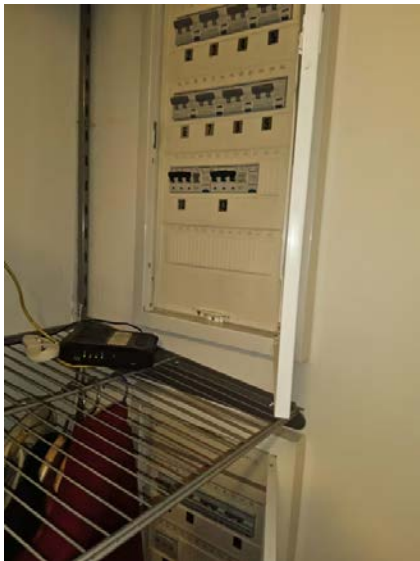
Sikringsskap er plassert på bod.
