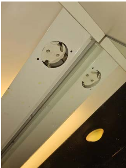
Løs/defekt stikkontakt i lysarmatur på bad.
