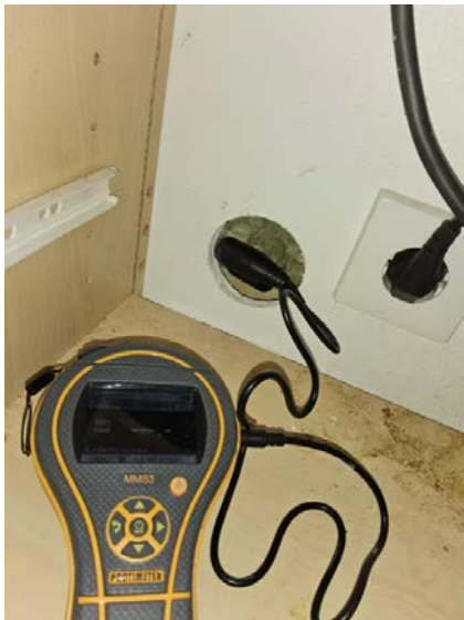
Bilde fra fuktmåling i tilstøtende veggkonstruksjon.
