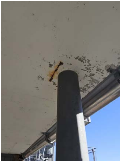
Avflasket maling og rustdannelser mot overliggende balkong.
