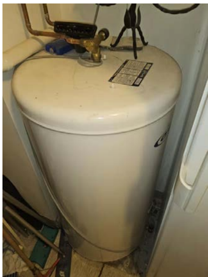
Varmtvannsbereder er plassert i bod.
