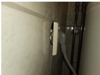
Stikkontakt til varmtvnsbereder på bad er løs.
