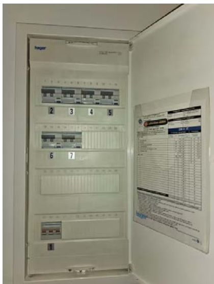
Sikringsskap er plassert i gang.
