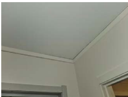
Riss/sprekker mellom listverk og overflater.
