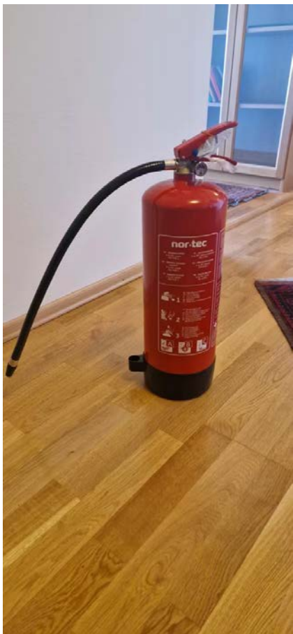
Nytt brannslukningsapparat er anskaffet etter befaring.
