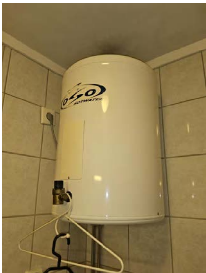
Vegghengt varmtvannsbereder plassert på bad.
