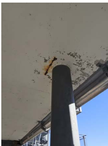
Avflasket maling og rustdannelser mot overliggende balkong.
