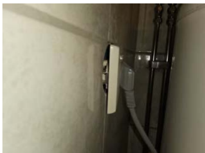
Stikkontakt til varmtvannsbereider på bad er løs.
