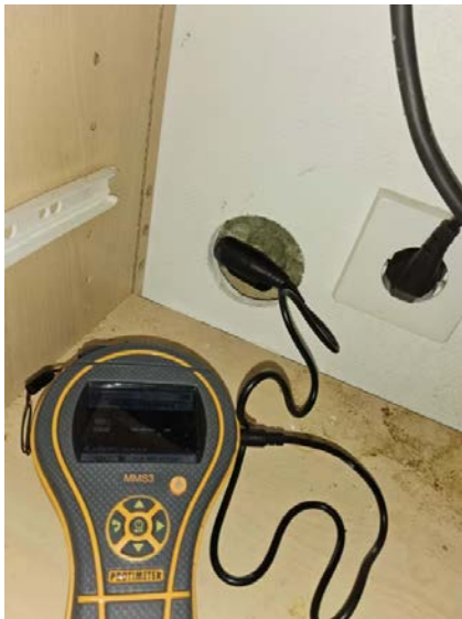
Bilde fra fuktmåling i tilstøtende veggkonstruksjon.
