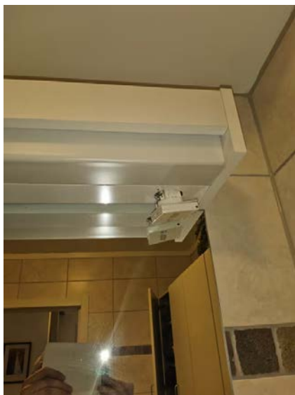
Løs/defekt stikkontakt i lysarmatur på vaskerom.
