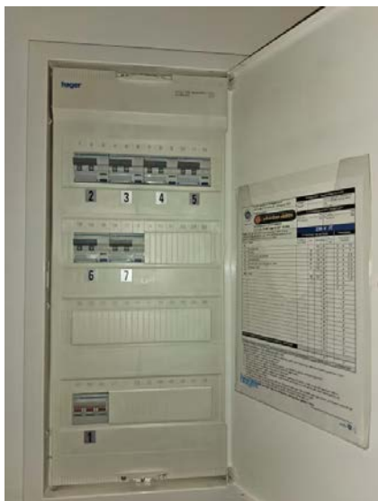
Sikringsskap er plassert i gang.
