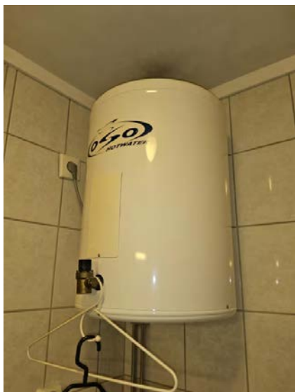
Vegghengt varmtvannsbereder plassert på bad.
