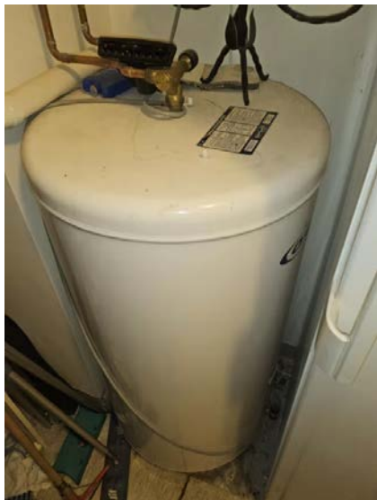
Varmtvannsbereder er plassert i bod.
