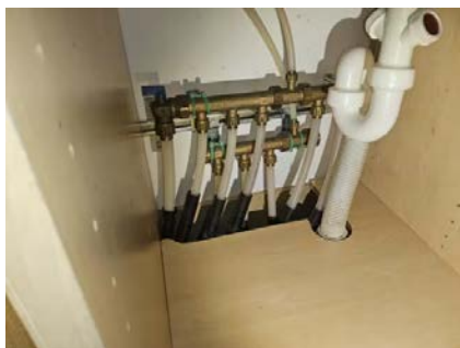
Åpen rørfordeling under kjøkkenvask.
