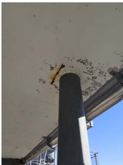
Avflasket maling og rustdannelser mot overliggende balkong.
