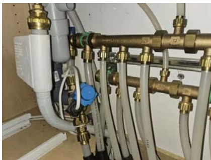
Åpen rørfordeling med automatisk vannstoppeventil under kjøkkenvask.
