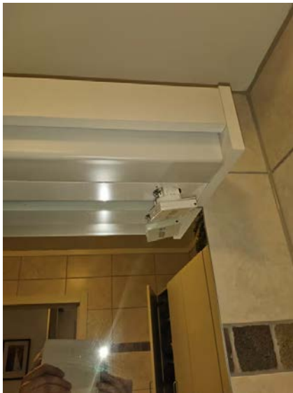
Løs/defekt stikkontakt i lysarmatur på vaskerom.
