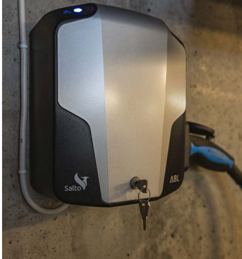
Det er koblet opp elbil-lader på plassen.
