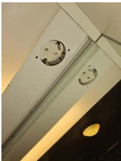
Løs/defekt stikkontakt i lysarmatur på bad.
