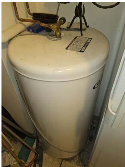
Varmtvannsbereder er plassert i bod.
