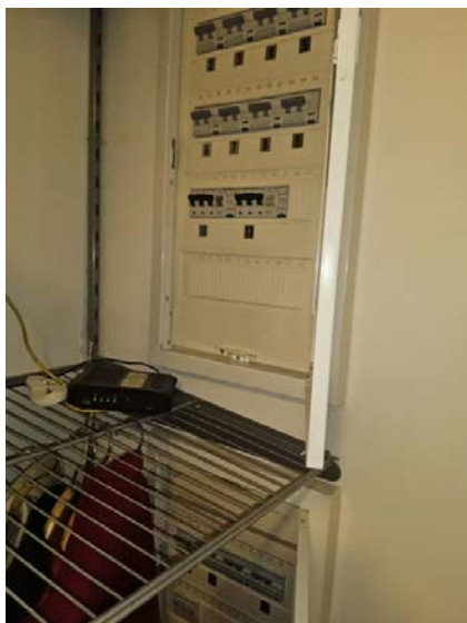
Sikringsskap er plassert på bod.
