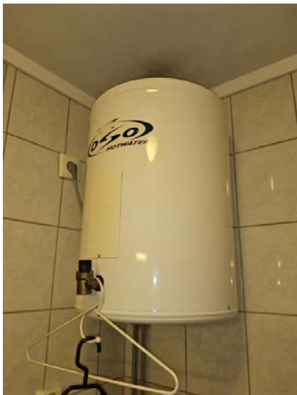
Vegghengt varmtvannsbereder plassert på bad.
