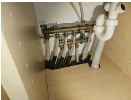
Åpen rørfordeling under kjøkkenvask.
