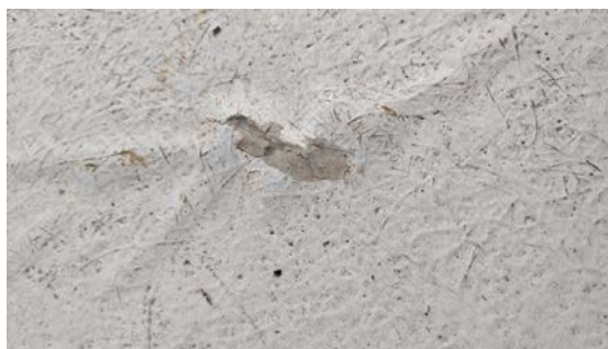
Skade i glassfiber
