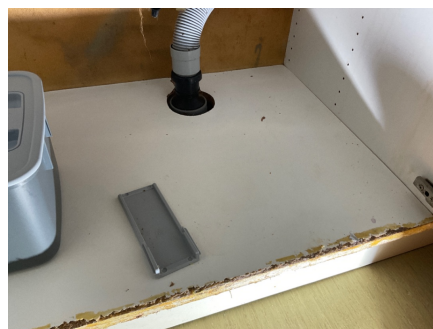
Svelling i benkeskap
