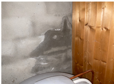
Fukt og saltutslag på innvendig grunnmur.
