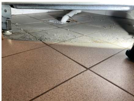
Sluk under dusjkabinett
