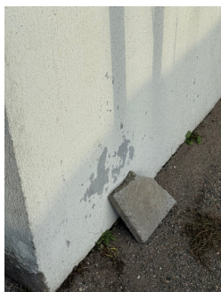
Malingsavskalling på grunnmur.
