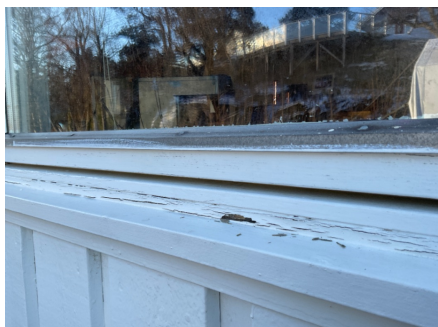
Begynnende råte på vinduskarm.
