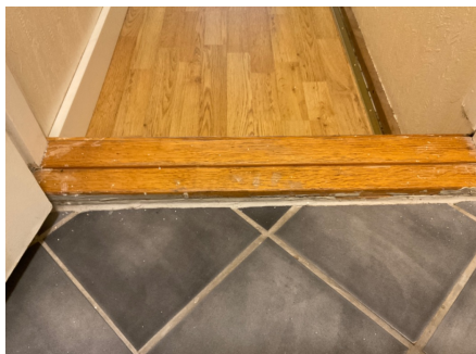
Manglende oppkant ved dørterskel.
