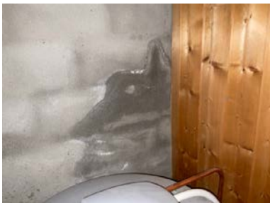
Fukt og saltutslag på innvendig grunnmur.
