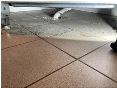
Sluk under dusjkabinett
