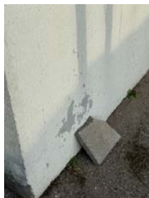
Malingsavskalling på grunnmur.
