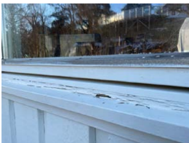
Begynnende råte på vinduskarm.
