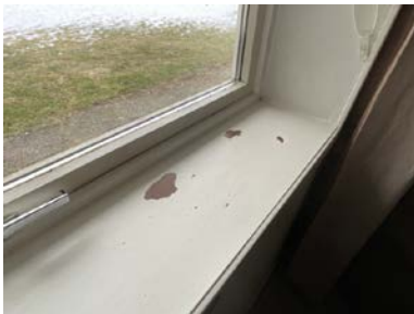
Det er noe malingsavskalling i vinduskarm hubel
