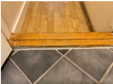
Manglende oppkant ved dørterskel.
