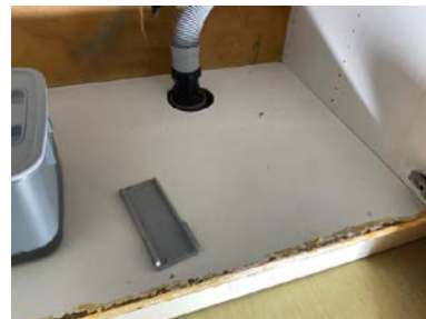
Svelling i benkeskap
