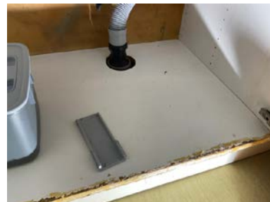
Svelling i benkeskap
