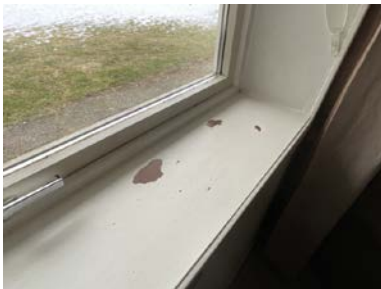
Det er noe malingsavskalling i vinduskarm hubel
