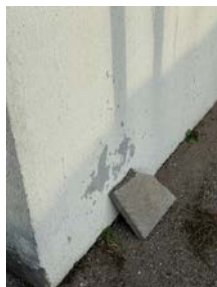
Malingsavskalling på grunnmur.
