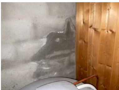
Fukt og saltutslag på innvendig grunnmur.
