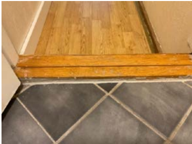
Manglende oppkant ved dørterskel.
