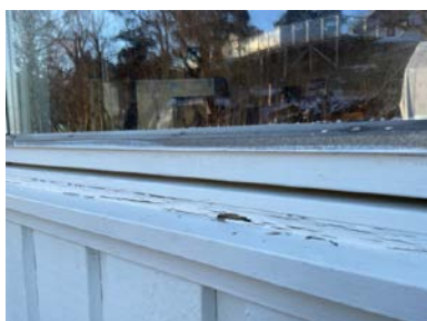
Begynnende råte på vinduskarm.
