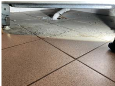
Sluk under dusjkabinett
