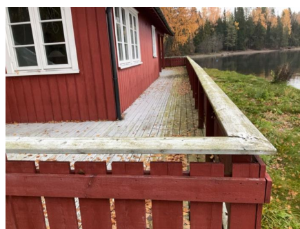
Konstruksjoner/overflater har vedlikeholdsbehov. Forenklet konstruksjon som krever ekstra ettersyn og vedlikehold.
