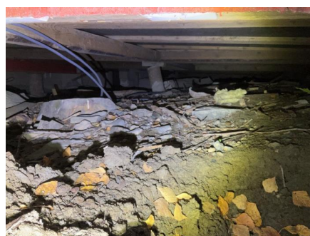
Skjevheter i fundamenter.
