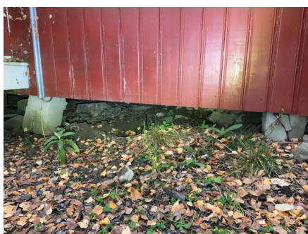
Skader i fundamenter.
