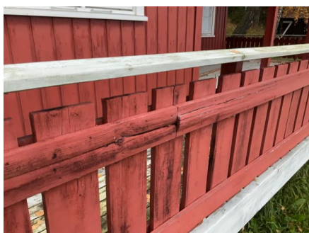
Det er registrert råteskader i rekkverk.
