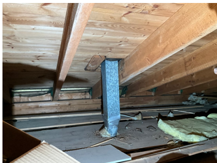
Mindre fuktmerker rundt gjennomføringer.
