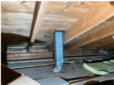
Mindre fuktmerker rundt gjennomføringer.
