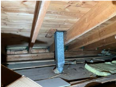
Mindre fuktmerker rundt gjennomføringer.
