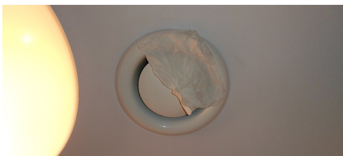
Funksjonstest av avtrekk.
