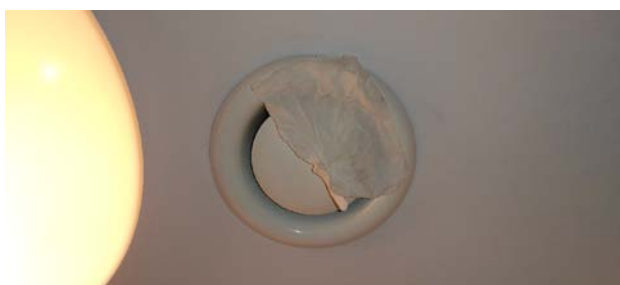
Funksjonstest av avtrekk.
