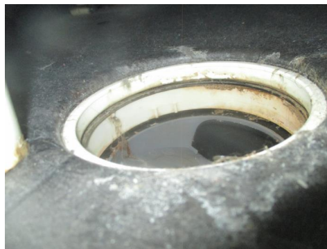
Sluk under dusjkabinett.
