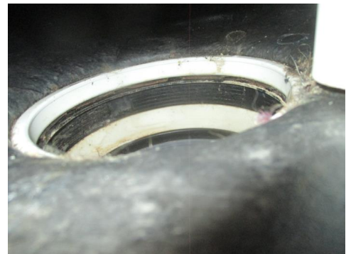
Sluk under dusjkabinett.
