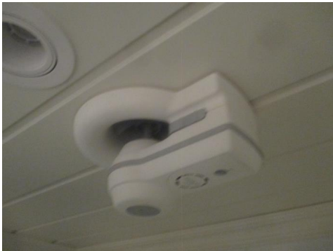
Avtrekk i himling.
