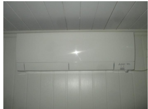
Varmepumpe i kjellerstue.
