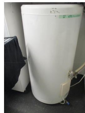
Bereder er plassert på vaskerommet.
