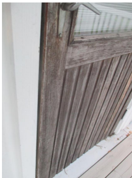
Balkongdør trenger vedlikehold.
