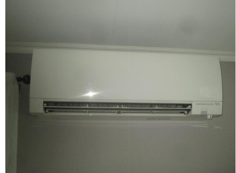
Varmepumpe i stue.
