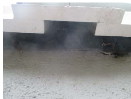
Er blitt lagt inn musebørster i bunnen av kledningen.
