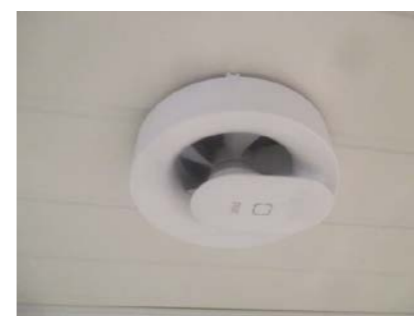
Avtrekk i himling.
