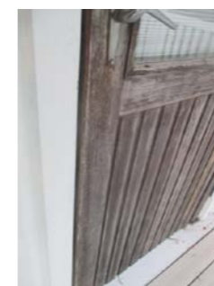
Balkongdør trenger vedlikehold.
