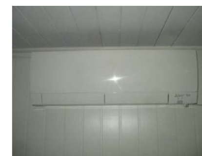
Varmepumpe i kjellerstue.
