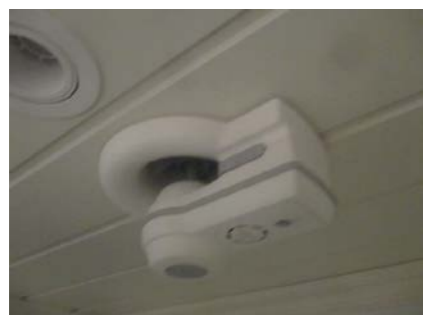
Avtrekk i himling.
