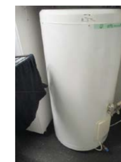
Bereder er plassert på vaskerommet.
