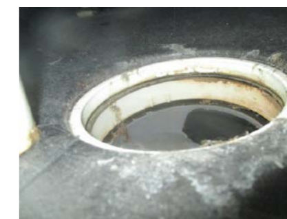
Sluk under dusjkabinett.
