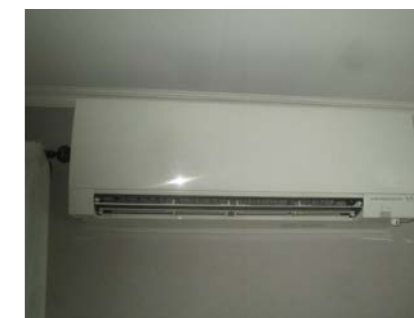
Varmepumpe i stue.
