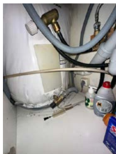
Rørpropp i kjøkkenbenk med Waterguard
