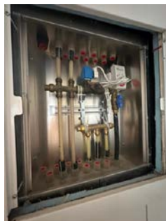
Samleskap med rørkurser og stoppekraner
