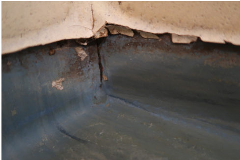
Bilde viser utetthet i gulvbelegg i dusjsone
