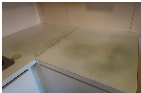
Bilde viser slitasje og misfarging på kjøkkenbenken.
