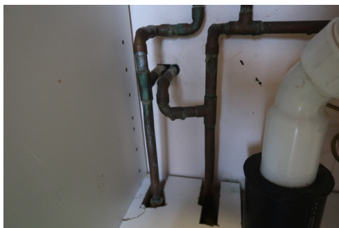
Bilde viser irrdannelse på kobberrør
