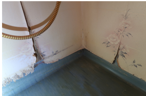
Bilde viser skader i våtromstapet
