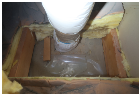
Bilde viser utett gjennomføring mot kaldloft
