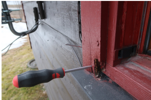
Bilde viser råteskade i omramming mot sør
