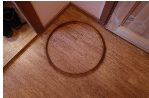
Bilde viser eksempel på misfarging av gulvbelegg. Bilde er tatt i entré
