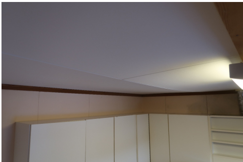
Bilde viser deformasjoner i innvendig tak i kjøkken
