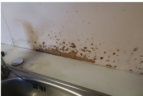
Bilde viser fuktskade på vegg ved vask
