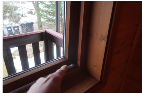
Bilde viser eksempel på vindu med justeringsbehov
