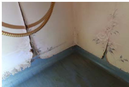
Bilde viser skader i våtromstapet
