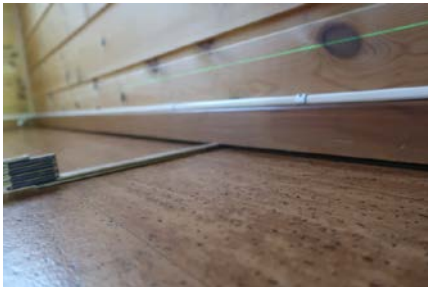
Bilde viser glippe mellom gulv og gulvlist i stue
