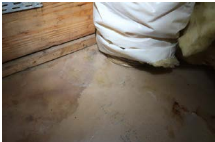
Bilde viser fuktskjolder ved gjennomføring av avtrekk fra kjøkken
