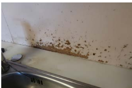
Bilde viser fuktskade på vegg ved vask
