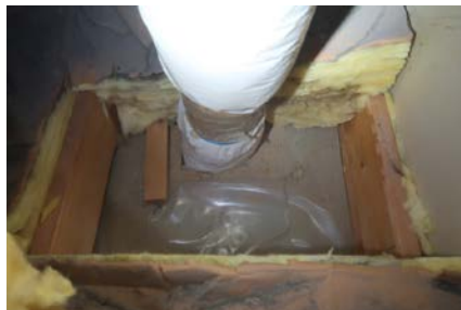
Bilde viser utett gjennomføring mot kaldloft
