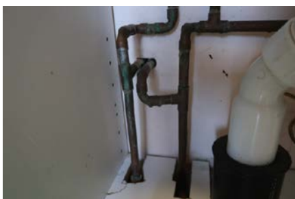
Bilde viser irrdannelse på kobberrør
