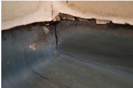
Bilde viser utetthet i gulvbelegg i dusjsone
