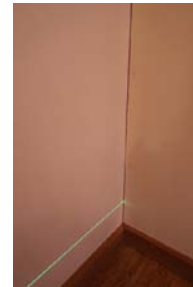
Bilde viser glippe/ sprekkdannelse i hjørne på soverom mot bad
