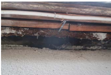
Bilde viser manglende luftespalte i nedkant av ytterkledningen
