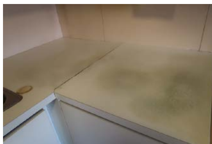
Bilde viser slitasje og misfarging på kjøkkenbenken.
