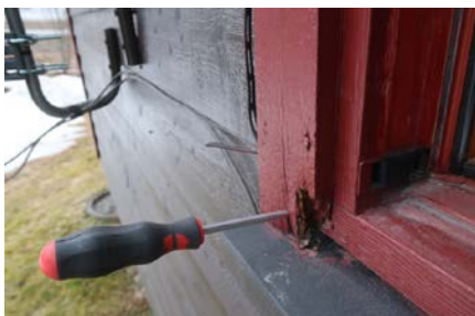
Bilde viser råteskade i omramming mot sør
