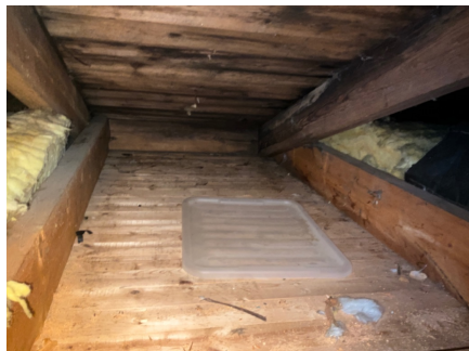
Mangler mye isolasjon.
