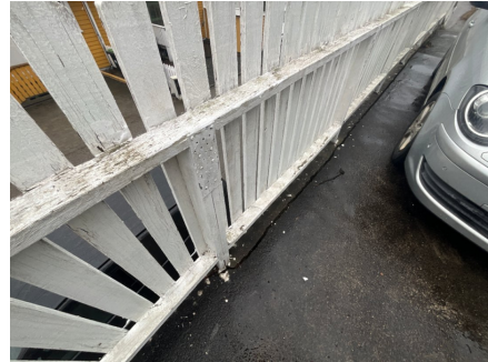
Det er glipe mellom asfalt og mur, fare for utgliding.
