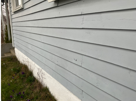
Ingen lufting bak kledningen.
