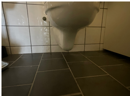
Mangler hull for drenering av lekkasjevann.
