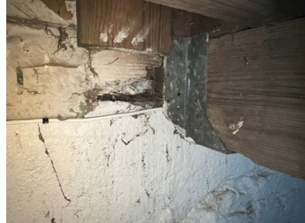
Mykt treverk bak deler av kledningen.
