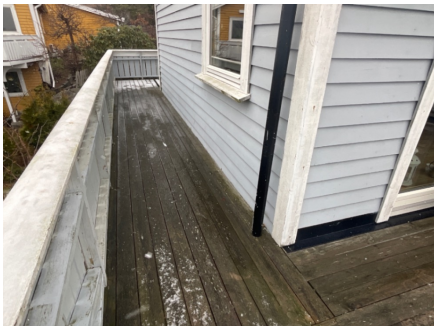
Kledningen er montert helt i mot dekke, uten beslag.
