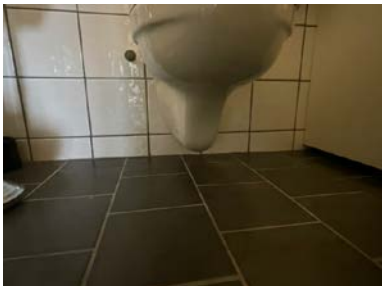
Mangler hull for drenering av lekkasjevann.
