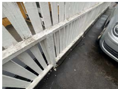
Det er glippe mellom asfalt og mur, fare for utgliding.
