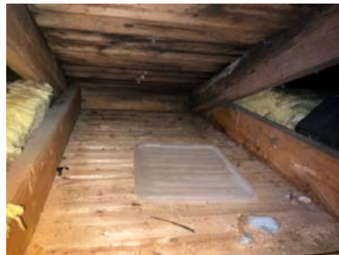
Mangler mye isolasjon.
