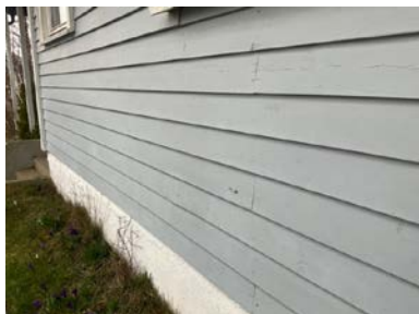
Ingen lufting bak kledningen.
