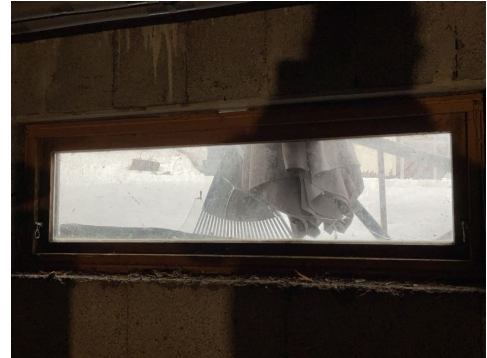
Sprekk i vindusglass i kjelleretasje.
