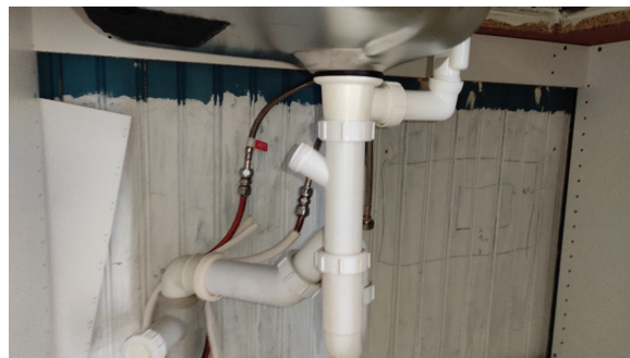
Kontroll etter lekkasjer.
