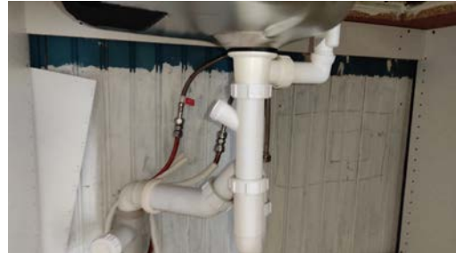
Kontroll etter lekkasjer.
