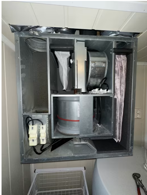
Viser ventilasjonsaggregat innvendig.
