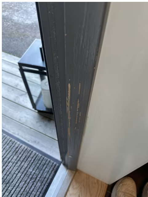
Slitasje på dørkarm ytterdør.
