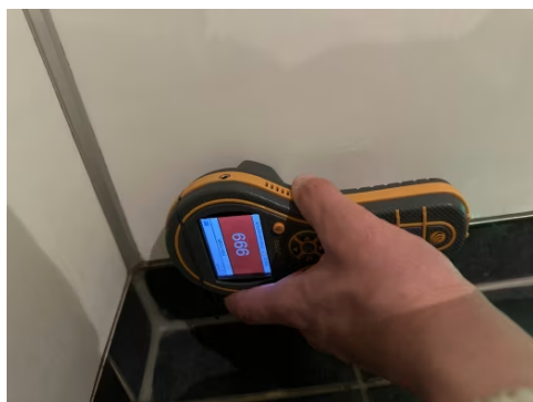
Viser fuktsøk på våtromsplate.
