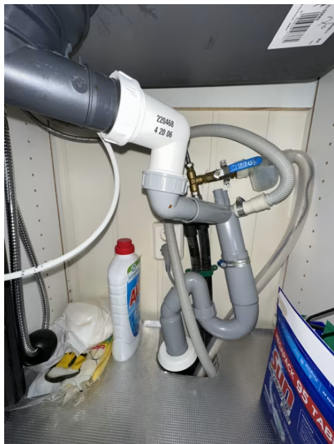
Viser vann og avløpsinnstallasjoner under kum.
