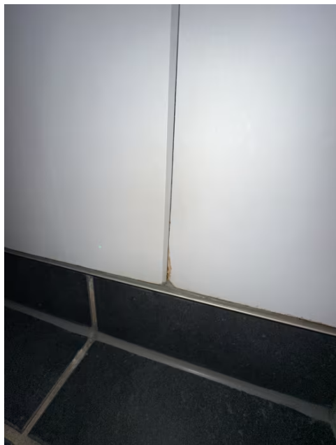
Det registreres glippe i skjøter imellom baderomsplater
