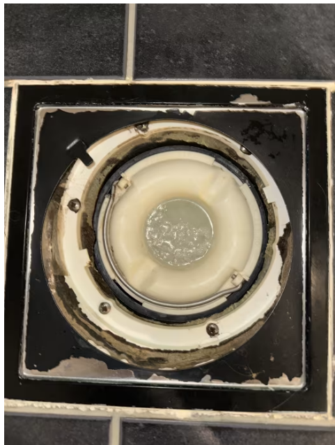
Viser sluk i dusjsonen. Synlig slukmansjett under klemring.
