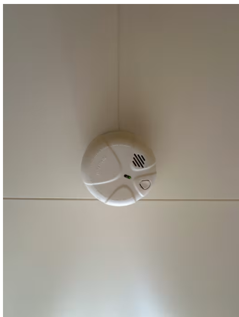
Viser brannvarsling i gang.
