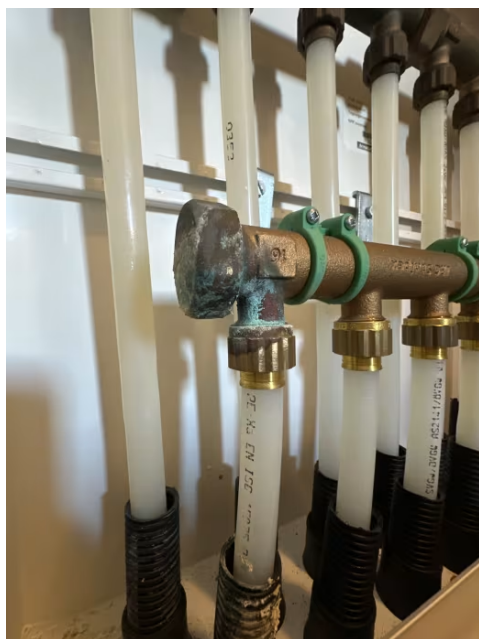
Der registreres drypplekkasje og irr på rørfordeler.
