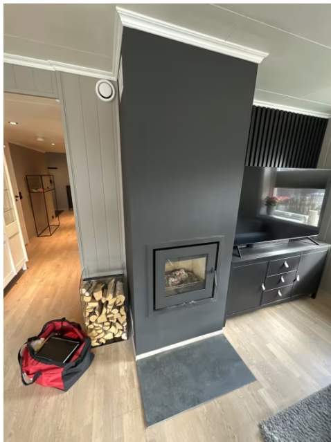
Viser ildsted i stue.
