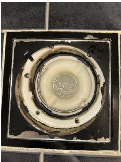
Viser sluk i dusjonen. Synlig slukmansjett under klemring.
