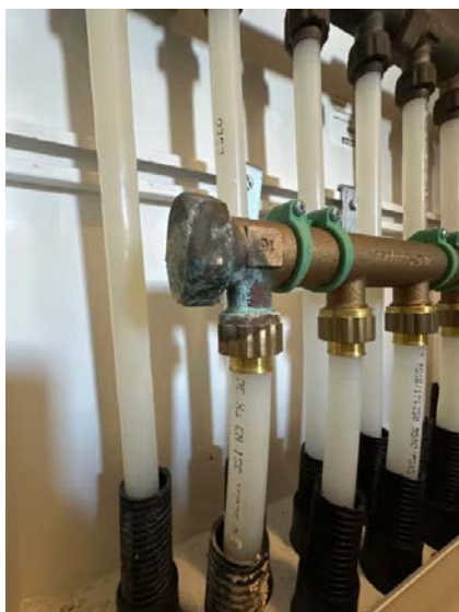
Der registreres drypplekkasje og irr på rørfordeler.
