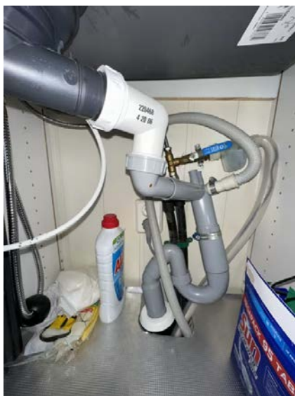
Viser vann og avløpsinnstallasjoner under kum.
