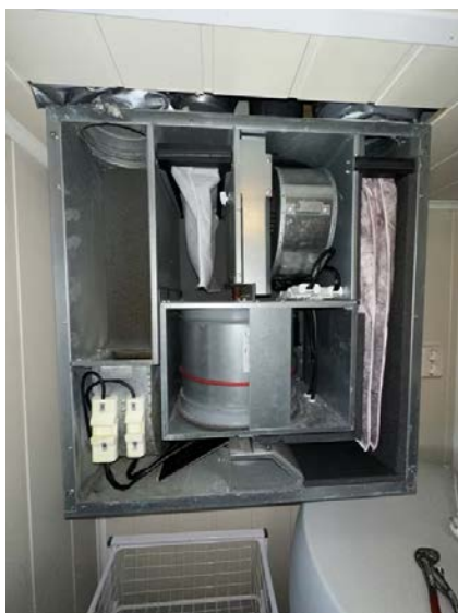
Viser ventilasjonsaggregat innvendig.
