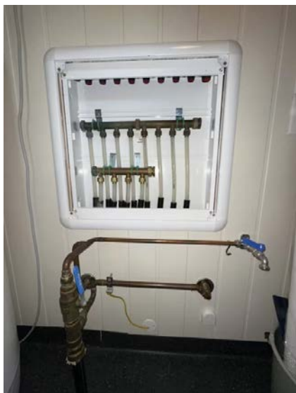
Viser vanninntak, hovedstoppekran og fordelerskap plassert i bod.
