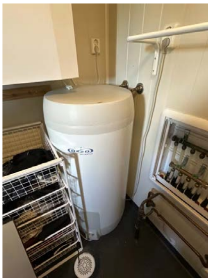
Viser bereder plassert i bod. Fast tilkobling av bereder utført etter befaringen.
