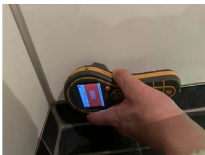
Viser fuktsøk på våtromsplate.
