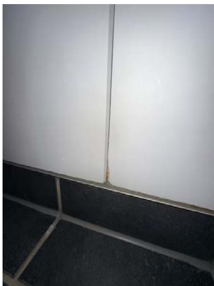
Det registreres glippe i skjøter imellom baderomsplater
