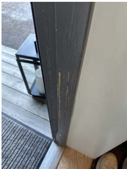
Slitasje på dørkarm ytterdør.
