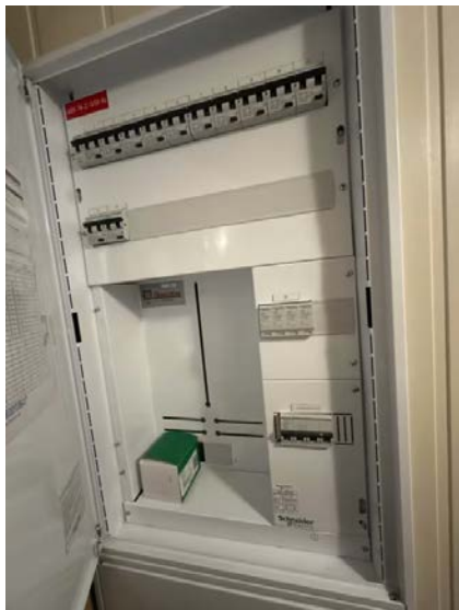
Viser sikringsskap plassert i bod.
